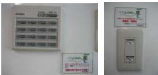
照明・空調スイッチの案内表示
